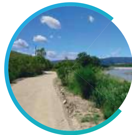
Finalisation du tronçon 2 entre l'épi du Fort et le pont des Gontards
