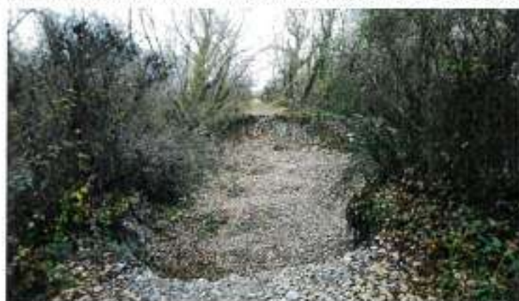
Figure 13: photo de la brèche de Rivebelle
